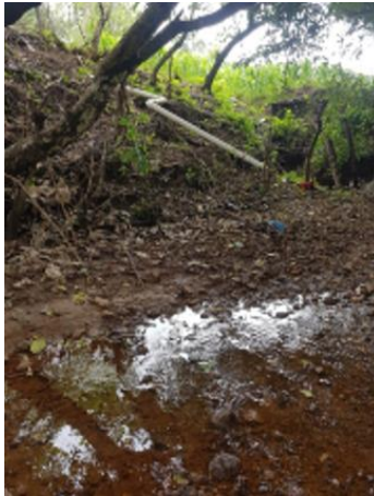
Figura 5. Tubería que descarga agua gris al río.
