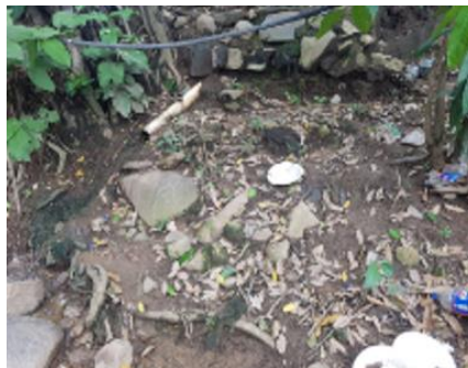
Figura 6. Tubo que descarga agua gris al río.
