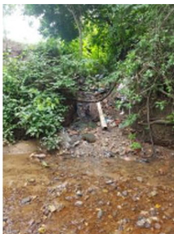
Figura 7. Tubo de descarga de agua gris.
